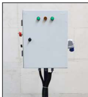
تابلو برق مجزا از دستگاه جهت راحتی کار
